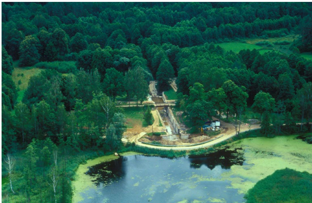
PL Śluza Kudrynki w czasie remontu. EN Kudrynki Lock during renovation. RU Шлюз Кудринки во время ремонта. Fot. Jarosław Borejszo
